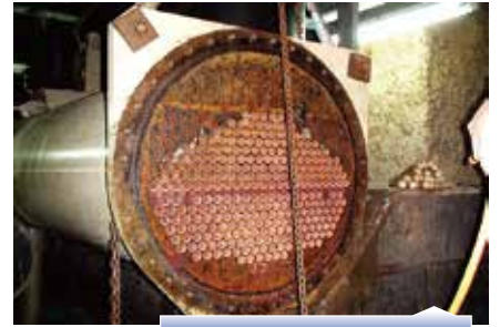
冰水機冷凝器
