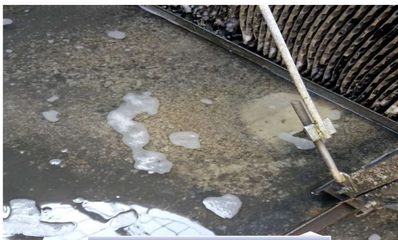
散熱材水垢剝落
