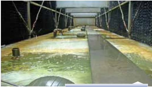
冷卻水塔循環水
