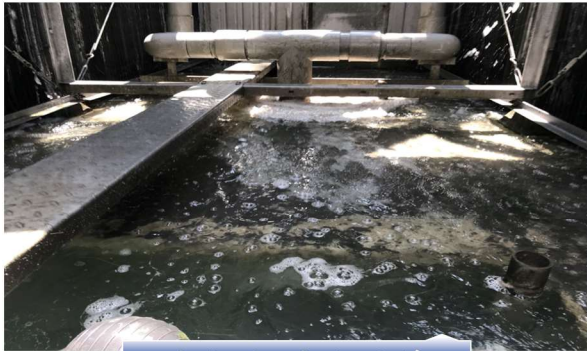
冷卻水塔使用前
