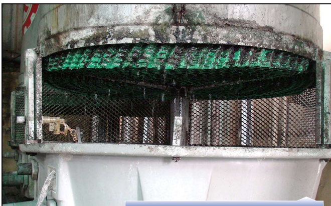
水垢造成散熱材塌陷
