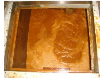
冰水槽產生銹水
