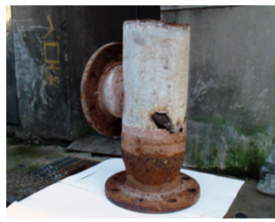
管路嚴重破損
